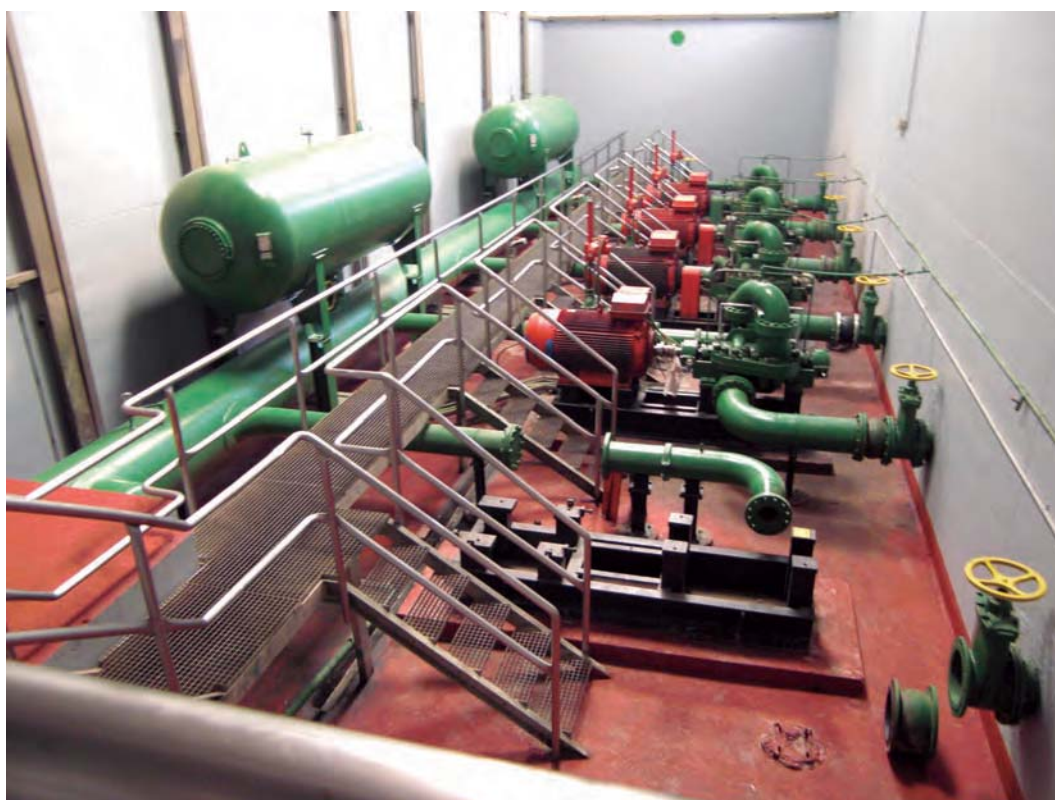
Foto 7.2. Sala de bombas en EBAR visitada (Tenerife - Canarias)
