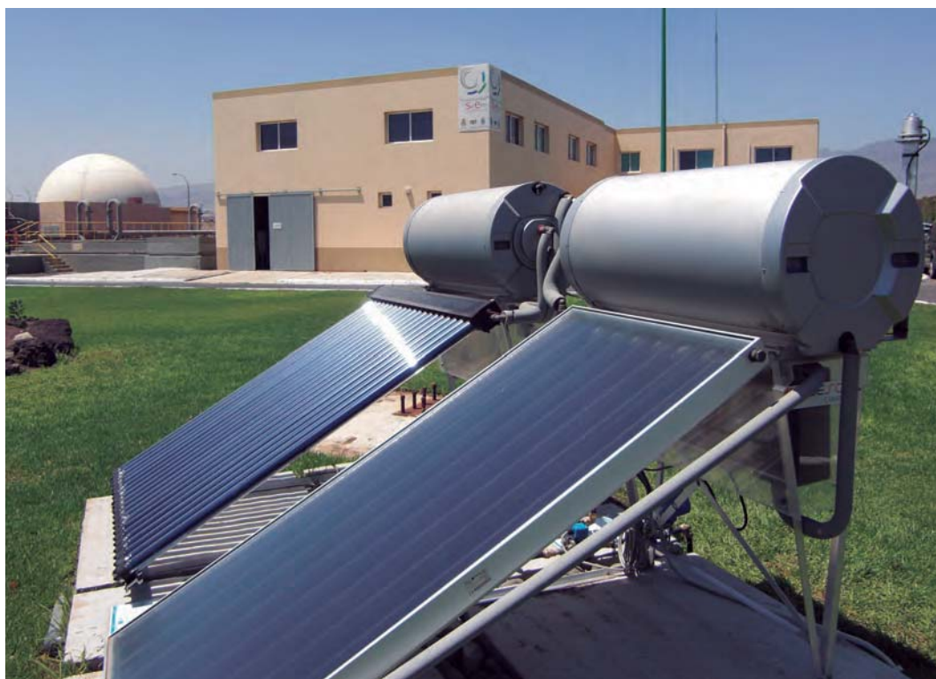
Foto 9.3. Vista frontal del prototipo de solar térmica para desinfección monitorizado en el proyecto
